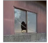
窓が割れた管理不全空家
